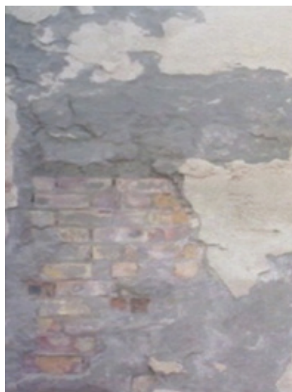
Рисунок 1 – Отслоение кусков штукатурки
