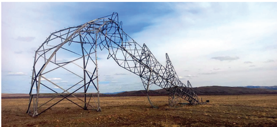
Рисунок 1 – Поломка опоры ВЛ 220 кВ от сильного бокового ветра
