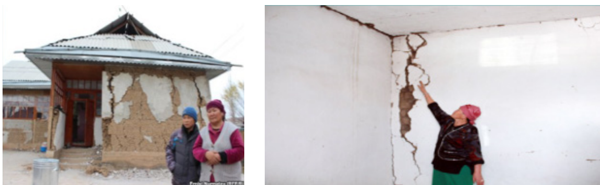
Рисунок 3 – Состояние домов после землетрясения в Карасуйском районе, 2015 г.
