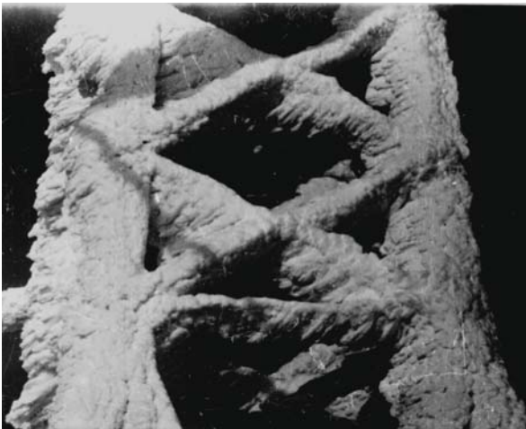
Рис. 1. Отложение плотной изморози на опоре ВЛ – 220 кВ (масса осадка около 20 кг/м), Сахалин, гора Подсека, высота 1000 м.
