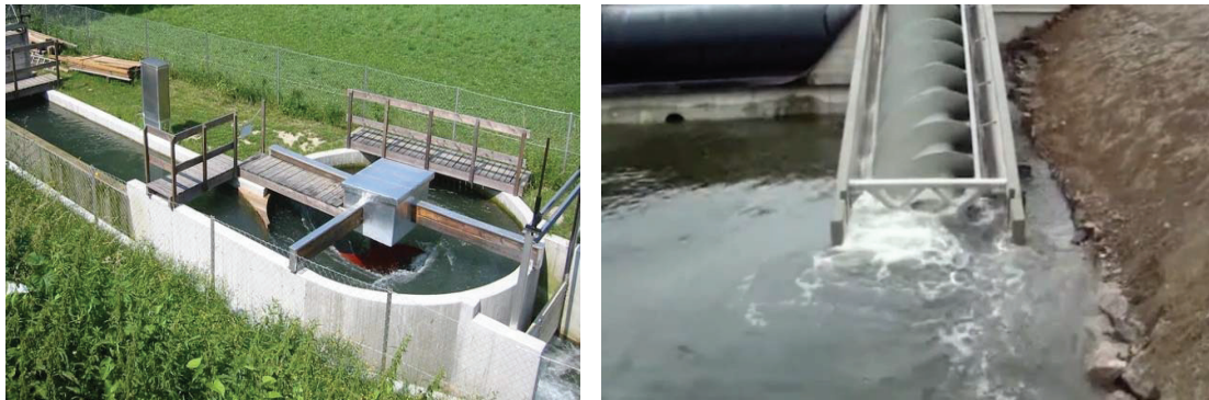
Рисунок 5 – Общий вид водоворотной и шнековой микро-ГЭС
