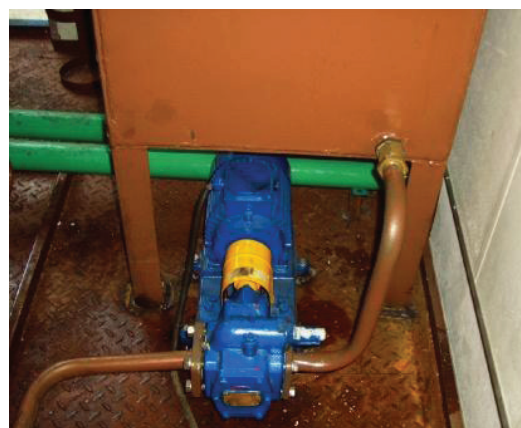
Рисунок 6 – Резервный масляный бак с маслоподкачивающим насосом
